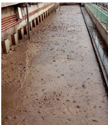
Decantador final al inicio.
